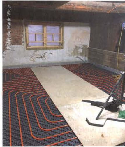
Abb. 16: Die auf 12 Zentimeter Schaumglas verlegte Fußbodenheizung sorgt heute in Verbindung mit der in Lehm verputzten Wandheizung am Ostgiebel für konstante behagliche Wärme.
