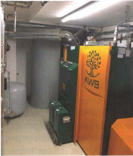
Abb. 15: Die moderne 49,5-KW-Pelletanlage versorgt heute zwei Wohnbereiche und den gewerblichen Bereich, insgesamt circa 600 Quadratmeter Wohn- und Nutzfläche.
