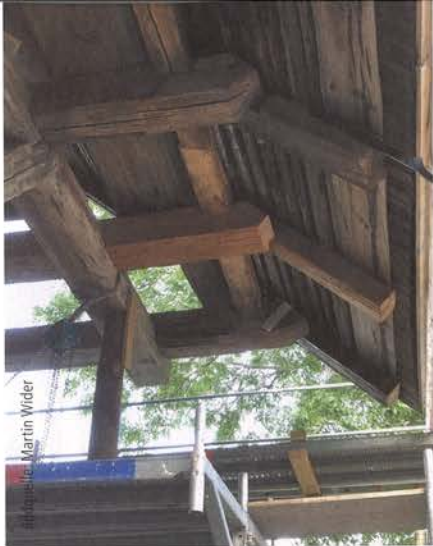
Abb. 2: Ein Deckengebälkspfahl sowie die zwei äußersten Sparrenköpfe mussten ersetzt werden. Die Stockfette wurde zum Teil ausgetauscht.
