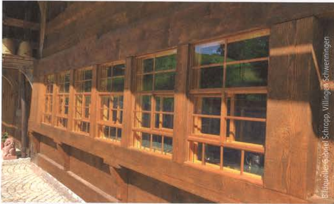
Abb. 6: Die äußeren Fenster im Alemannischen Fensterband sind nach historischem Vorbild hergestellt und nicht beweglich. Die Belüftung wird durch seitliches Verschieben des mittleren Schiebeflügels gewährleistet.
